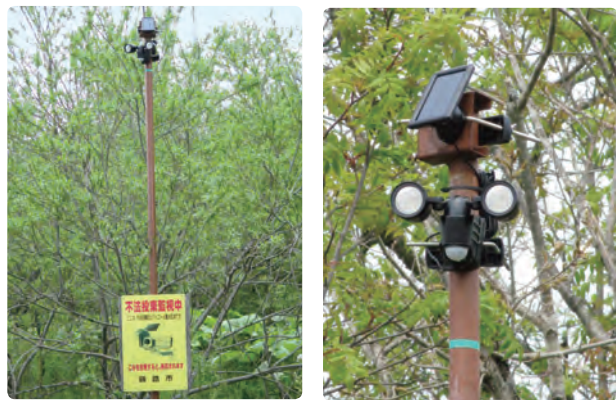
センサーライト・看板の設置例
