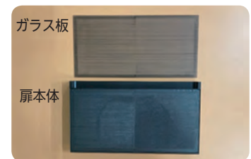
剥離したガラス板と扉本体
