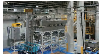
導入中の浮沈選別装置
